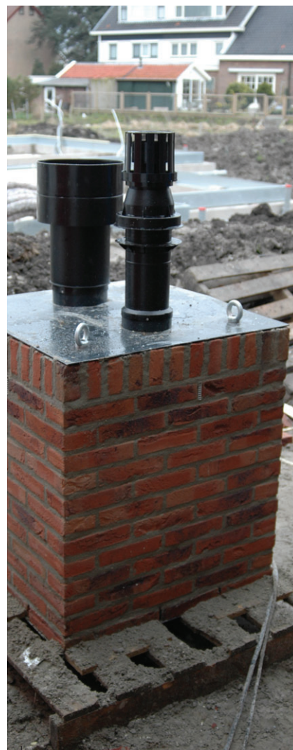
De op de grond gemetselde schoorsteenkolom met bovenplaat en doorvoeren. Aan de hijsogen wordt het geheel naar zijn plek op het dak getild.
