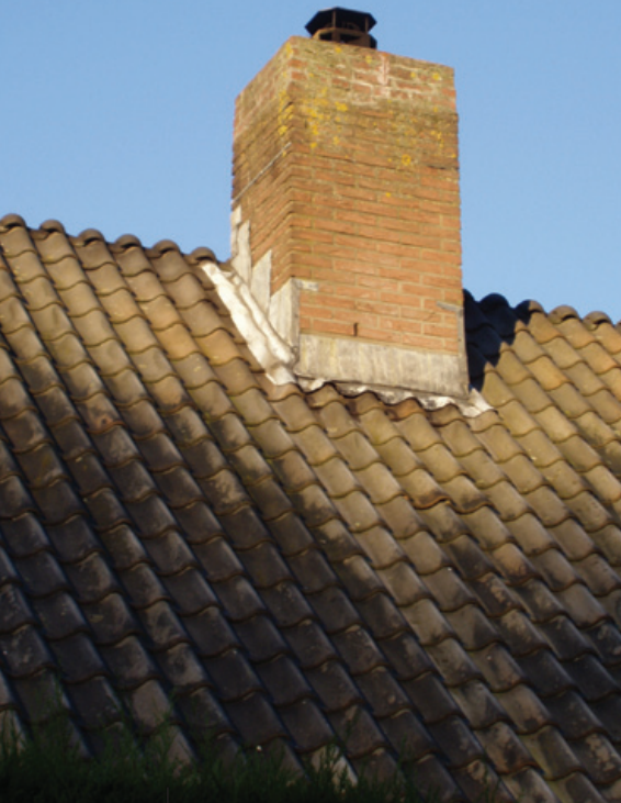
De oude schoorsteen lekte en zag er niet echt fraai uit.
